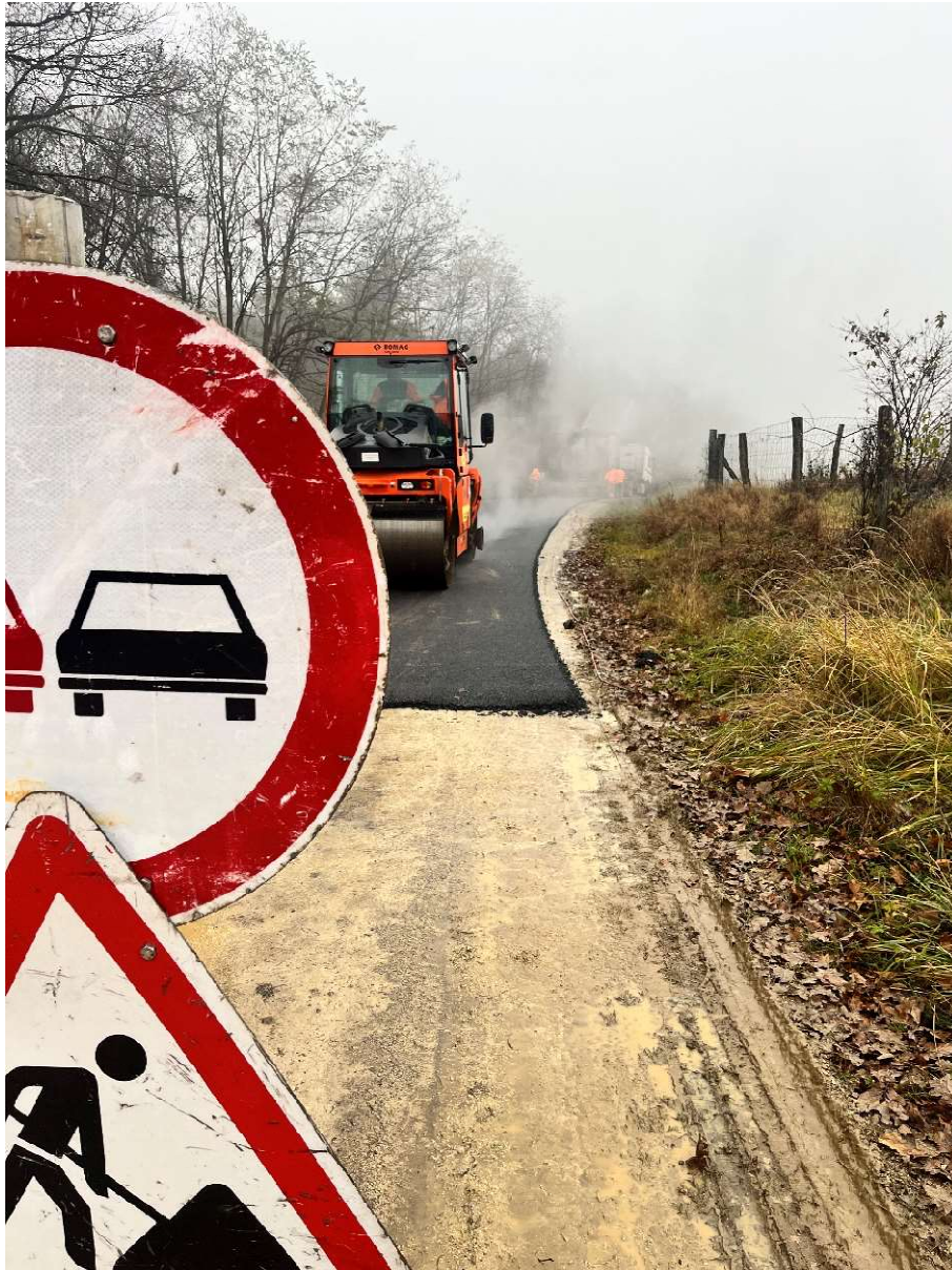
Egyéb közutak bitumenes burkolatának készítése, hengerelt aszfalt kopóréteg készítése (AC), az alatta lévő réteg felületének előzetes letakarításával és bitumenes permetezéssel,
